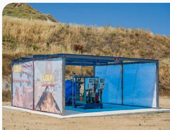
Foto 2 | Gruppo di pompaggio
